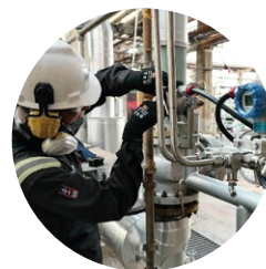
Diagnóstico y Mantenimiento de Válvulas
